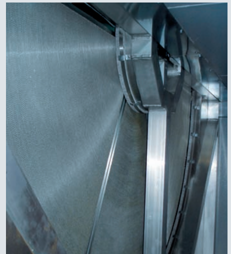
Innenaufnahme im Zentralgerät Rotationswärmetauscher mit Feuchterückgewinnung
