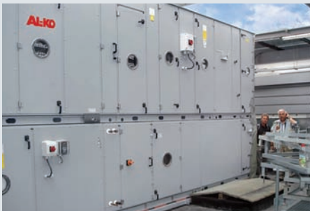
Außenaufnahme Zentralgerät in der begehbaren Dachzentrale
